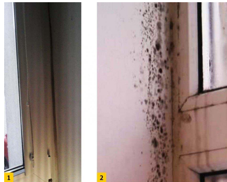
FOT. 1-2. Pleśń na styku okna ze ścianą;
